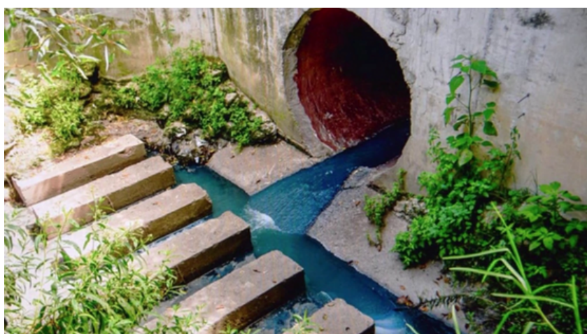
Figura 1. Contaminación de río por agua residual industrial (Olguín y Rojas, 2017).
